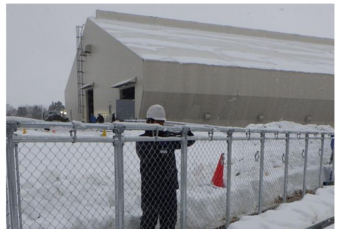
写真2.3 積雪深 60 cm時の屋根堆雪状況
