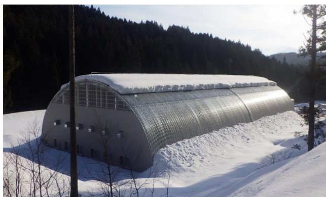
写真3. 3 積雪深 60 cmにおける屋根積雪状況
