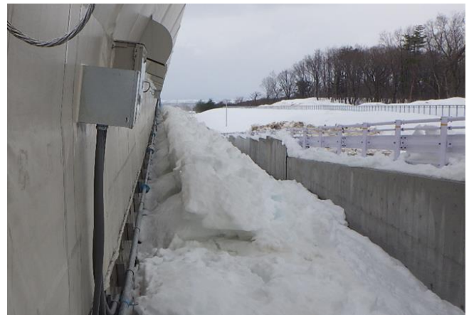
写真2. 6 落雪溝融雪散水
