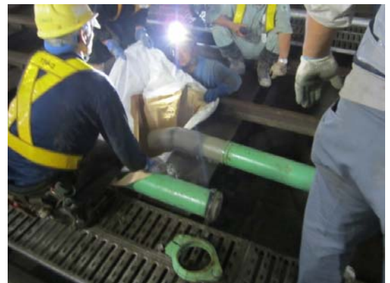
写真－2 ポンプ施工における配管閉塞
