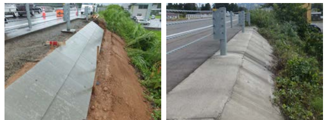
写真-12 施工後の経年変化 (左：施工時、右：施工後 3 年経過)
