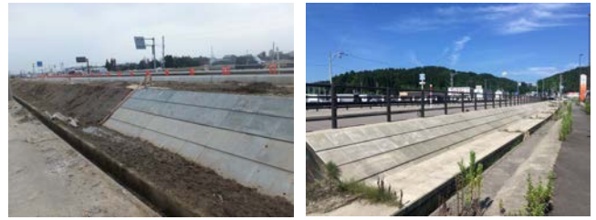
写真-11 施工後の経年変化 (左：施工時、右：施工後 3 年半経過)
