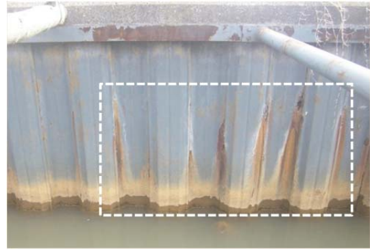
図-2 表面被覆材の再劣化事例
