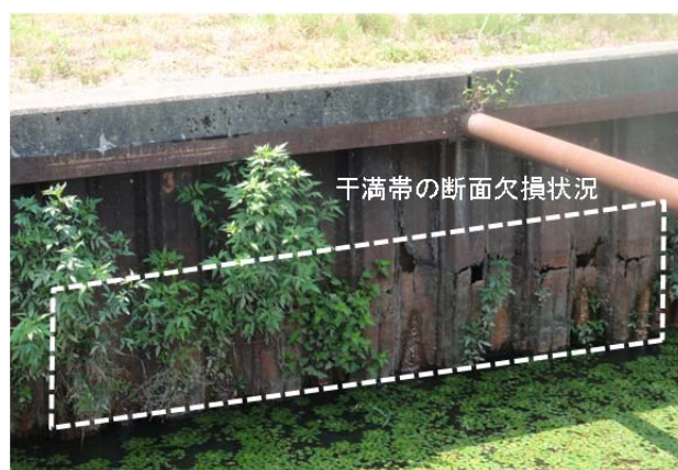
図-1 鋼矢板水路の腐食と断面欠損
