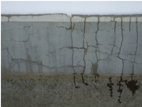
写真-1 PCM 早期ひび割れの例
