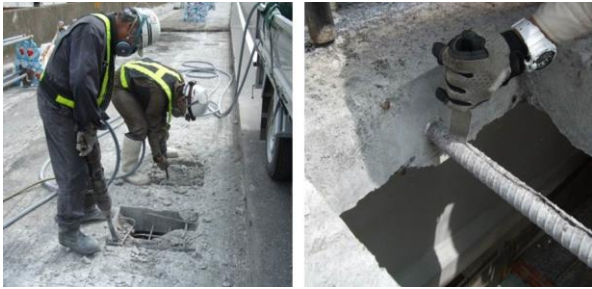
写真-4 コンクリートはつり・PC鋼材露出
