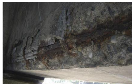
写真-1 主桁鉄筋の腐食状況
