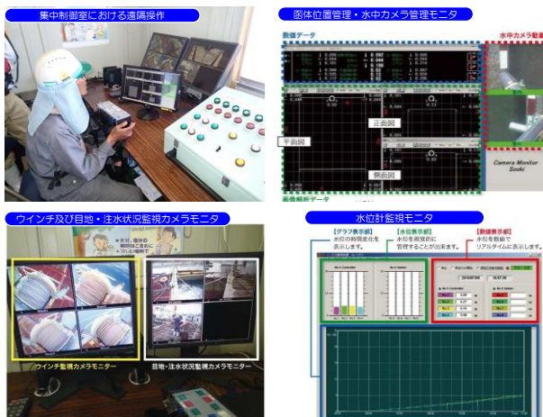
図－3 集中制御室での遠隔操作状況
