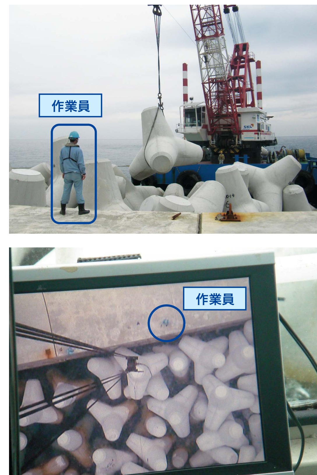
クレーンカメラによる吊荷周辺監視
