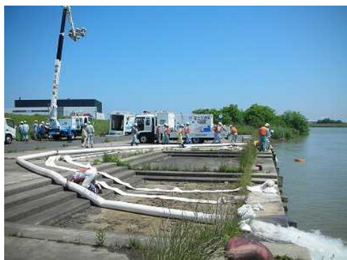
排水ポンプ車を使った排水訓練の例
