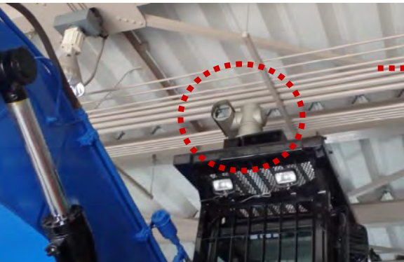
カメラ取付状況
