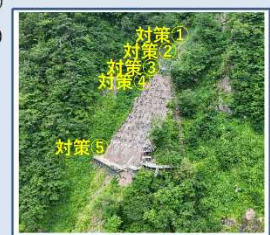
◀ 落石対策設置状況 ▶
