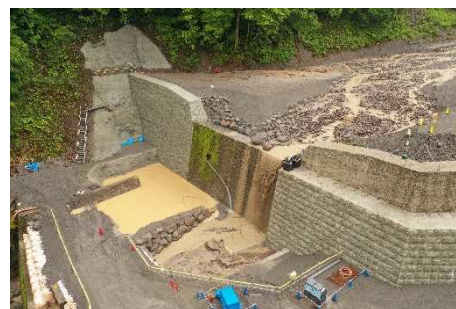
【土石流発生直後】
