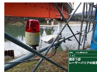
レーザーバリア設置状況
