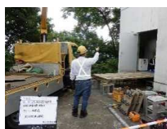
風向風速目視確認
