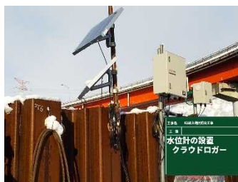
水位計設置状況
