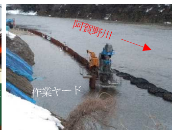
阿賀野川出水時冠水状況
