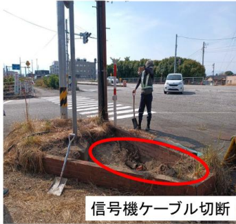
事故発生箇所
