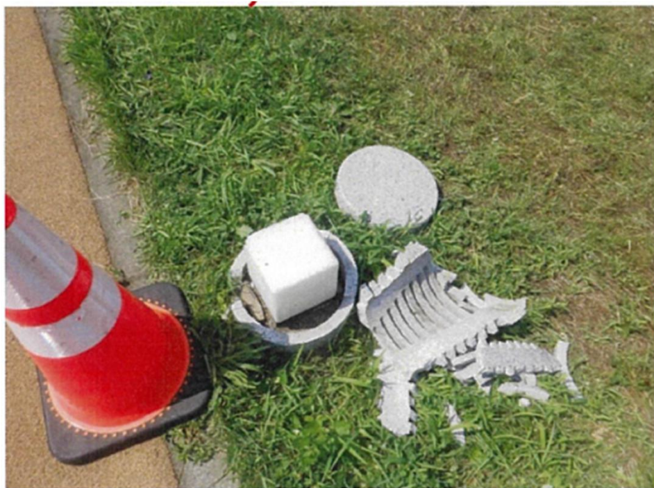
破損したスツールライト
