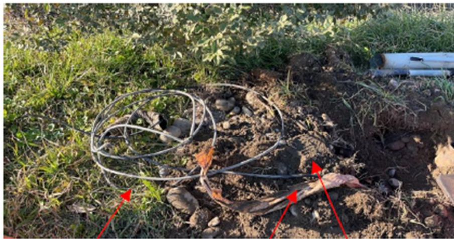
光ケーブルSM4C 埋設シート 埋設配管FEP50
