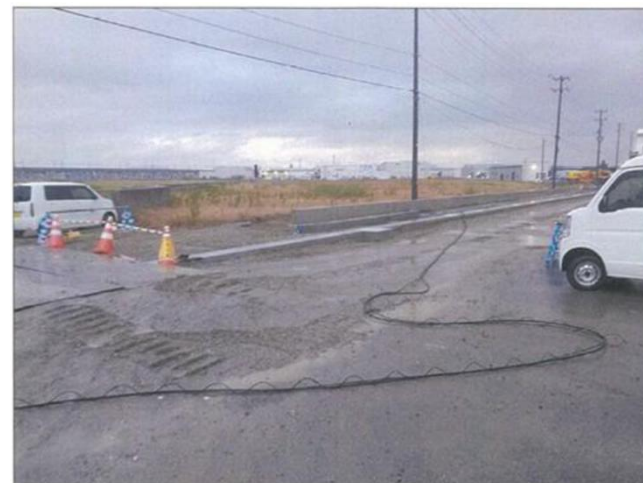
【事故状況写真】
