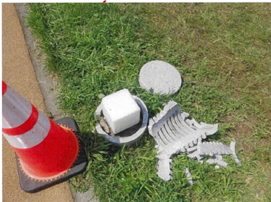
破損したスツールライト
