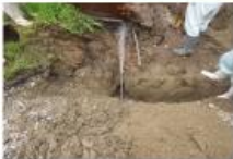
水道管破損状況
