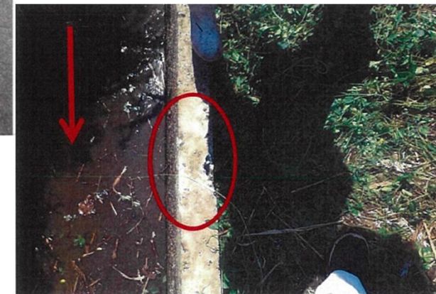
滑落した除草機と水路の損傷状況
