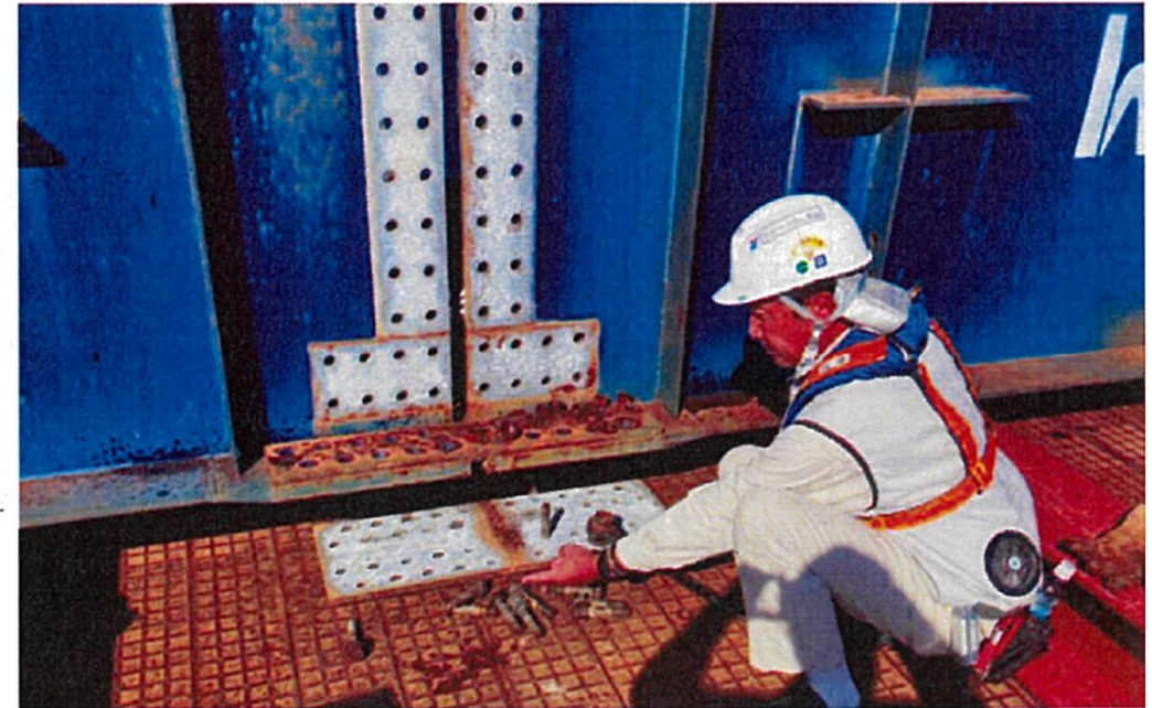
事故発生時の状況
