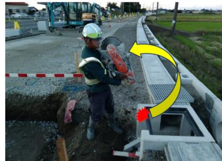
エンジンカッターの刃がグレーチング受枠に当たり跳ねて刃で顎を切った。（フェイスガードで守られていない部分）
