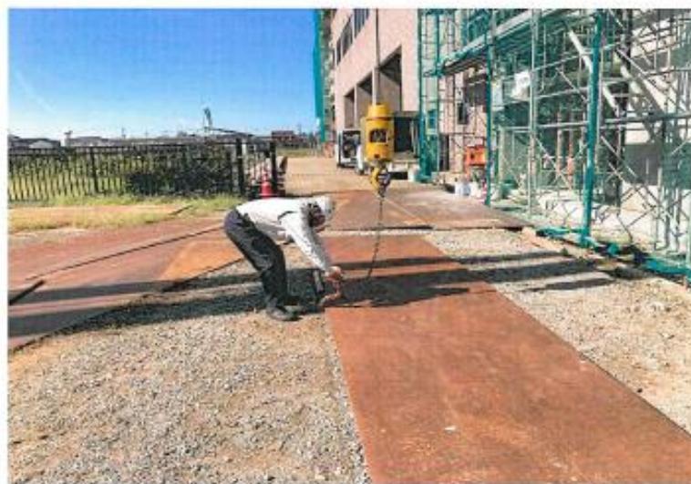
被災時作業再現（遠景）
