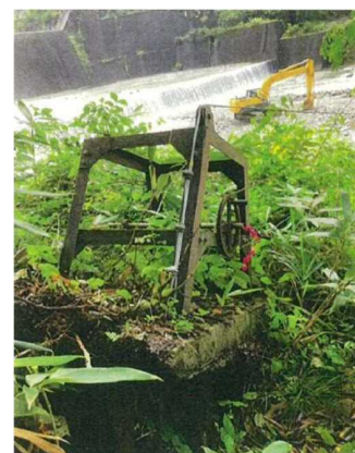
被災状況写真(基礎部の浮き上がり)
