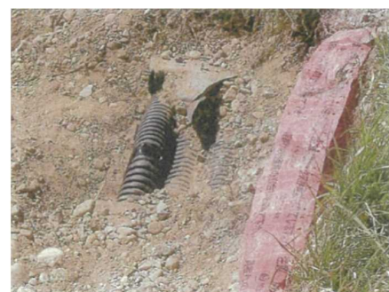
損傷状況写真
