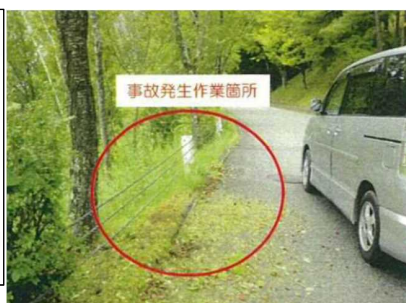
事故発生状況
