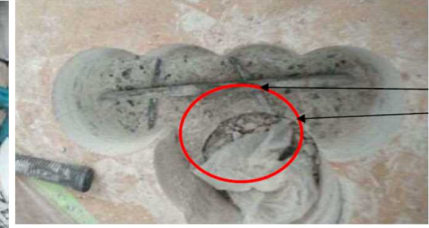
破損箇所 当初位置
