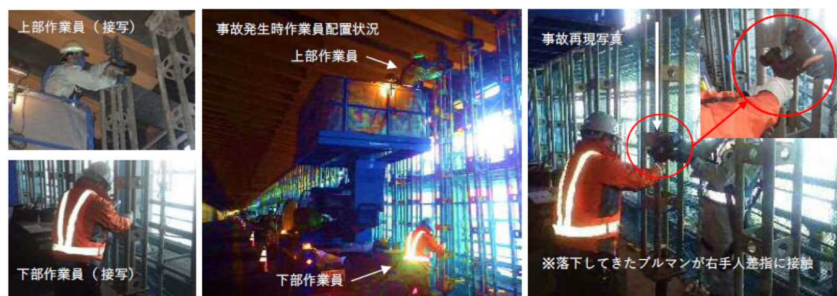
事故状況写真
