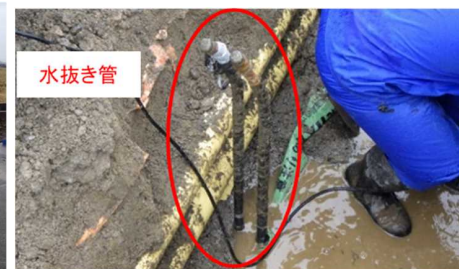
事故発生状況写真
