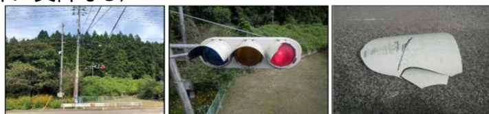
写真1 事故発生箇所 写真2 破損した信号機 写真3 落下した信号機破損部
