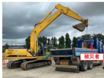
事故発生時の状況(全景)
