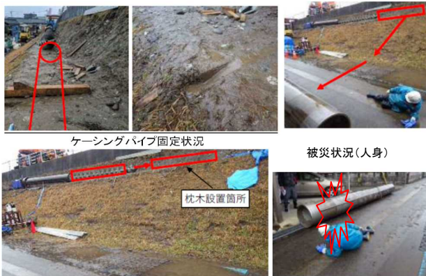
事故発生状況
