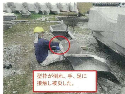
被災状況写真
