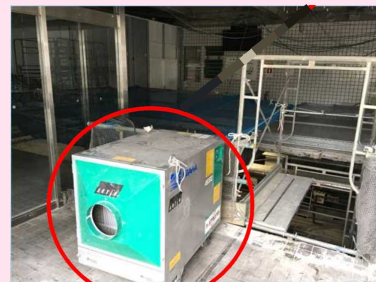
集塵機を設置し室内の換気を実施
