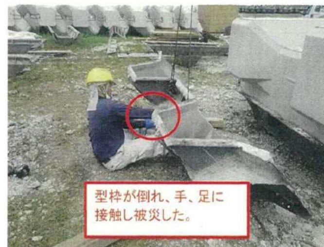
被災状況写真
