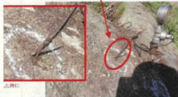
法枠から突出した釘(長さ50mm)
