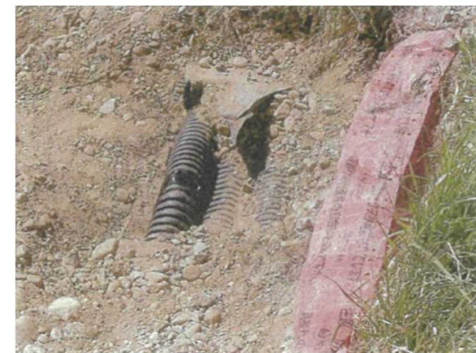
損傷状況写真
