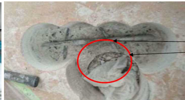
破損個所当初位置
