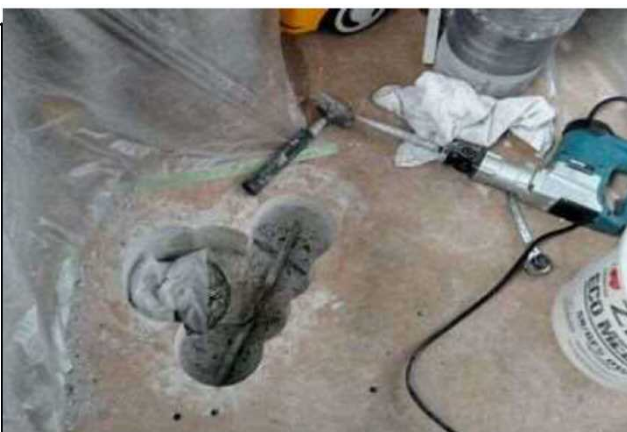
穿孔機で既存電線管損傷状況
