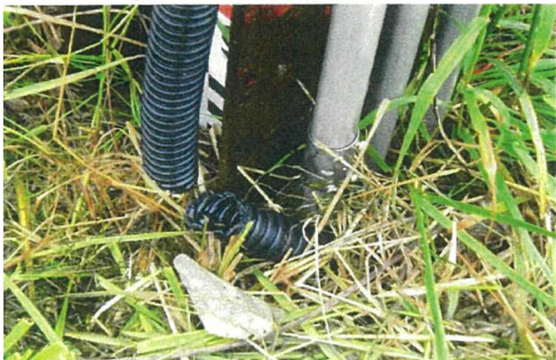
[信号ケーブルの切断状況]
