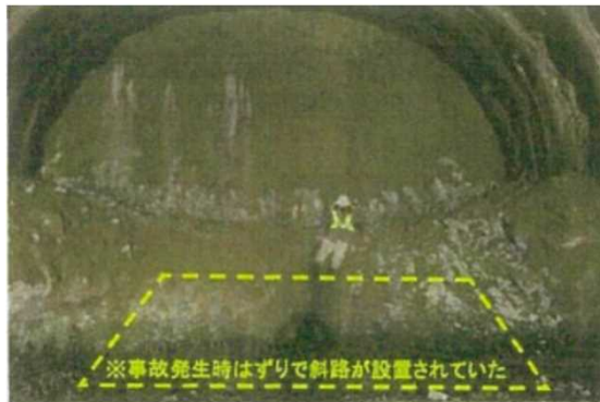
事故状況(全体)
