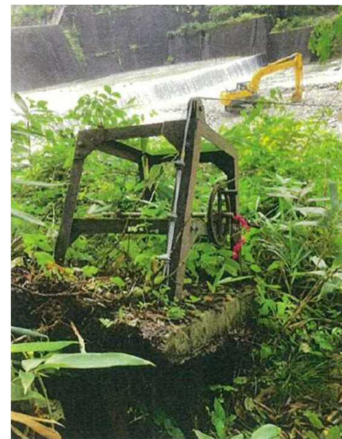
被災状況写真(基礎部の浮き上がり)
