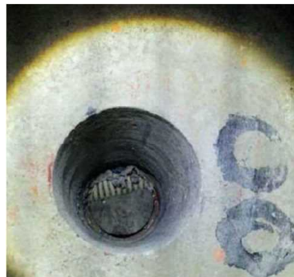
PF管損傷状況
