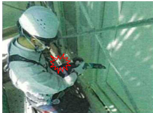
写真のように中腰で作業していて、配管カバーの入り隅辺りにグラインダーが接触した反動で跳ね返り、衝撃でグラインダーが手から放れ、グラインダーの刃が作業員の左膝にあたり負傷
