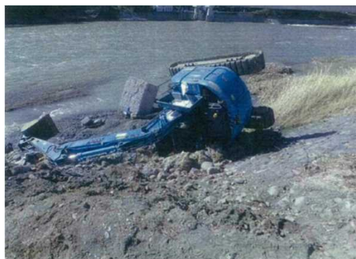
機械転落状況
