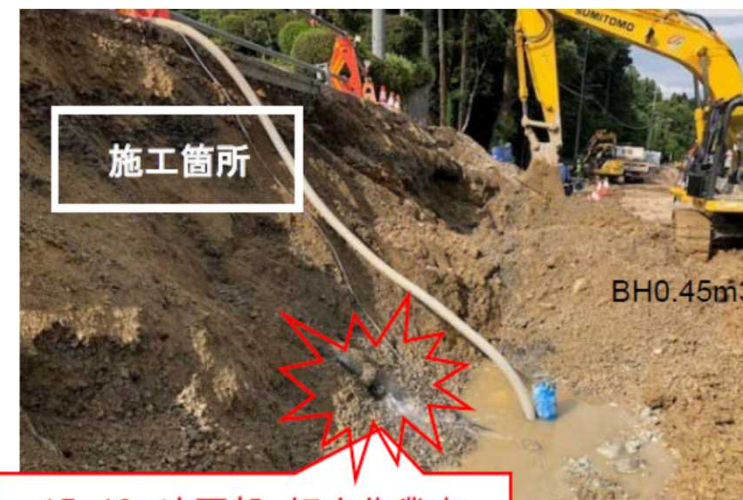
15:46 法面部 切土作業中 下水道圧送管に接触
