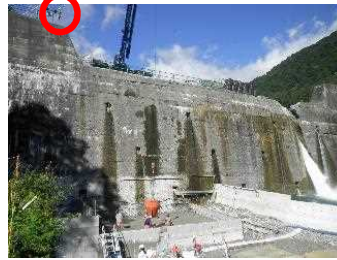
【写真-1】 (1年目前年工事) 堰堤袖部にWeb カメラを設置
