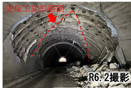
地震によるトンネル覆工崩落
