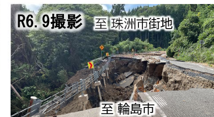
大雨による補強土壁崩壊
