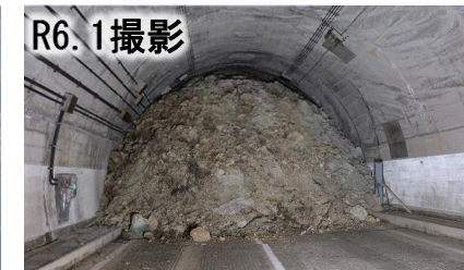
地震による逢坂トンネル輪島側坑口閉塞状況
