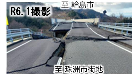
地震による烏川大橋損傷状況
