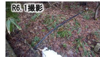
地震による既設アンカー破断
