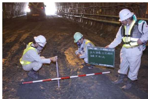
湧水による路盤泥濘化状況
