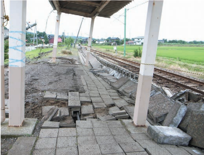
図-4.1 液状化による荒浜駅ホームの陥没
