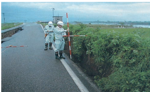
図-4.5 液状化により沈下した河川堤防
