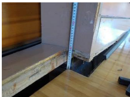
体育館床の沈下②
