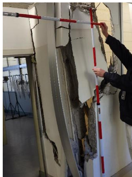
倉庫入口部分の破損
