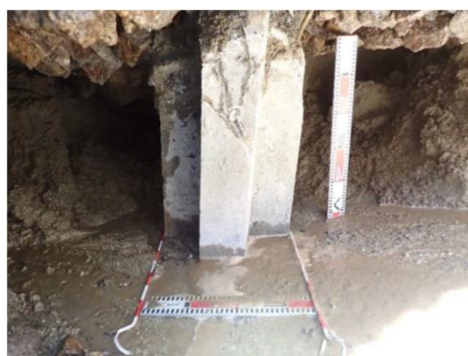
杭頭クラック
