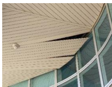
天井材の脱落
