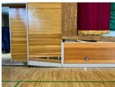
体育館床の沈下①
