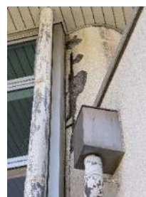
柱のひび割れ
