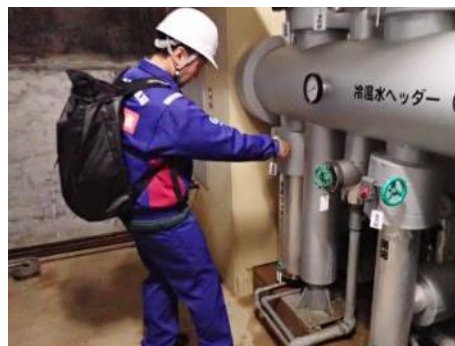
漏水系統バルブ閉塞
