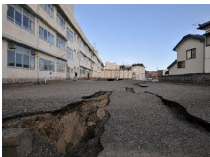
地盤の地割れ・陥没
