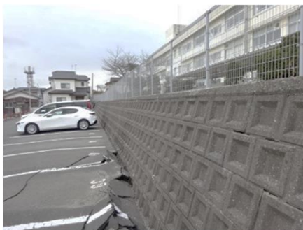
南面擁壁の移動・沈下
