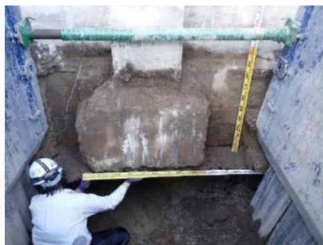
基礎梁クラック
