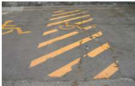
写真5 アスファルト舗装の区画線の欠損
