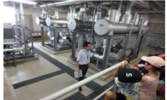
機械室の機械が大きくて基地みたい！
