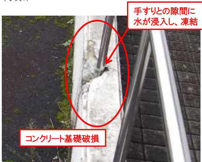
写真7 手すり基礎の破損
