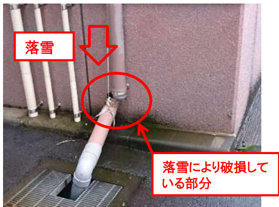
写真2 雨水用ドレン配管が破損
