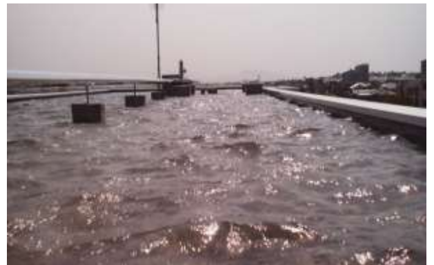
写真9 ルーフトレンの目詰まりによる屋上のプール化の状況
