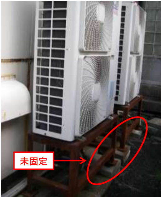
写真4 エアコン屋外機未固定
