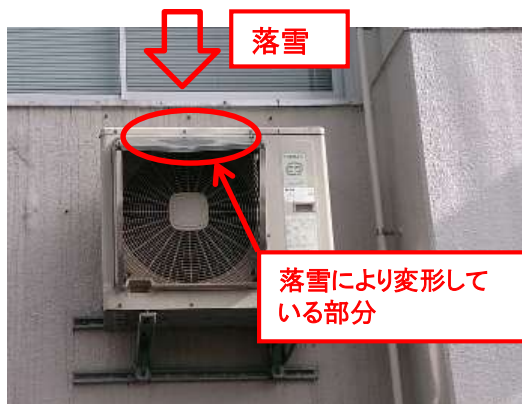
写真1 室外機用フードが変形
