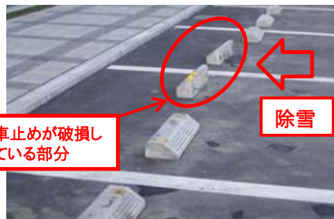
写真3 車止めが破損
