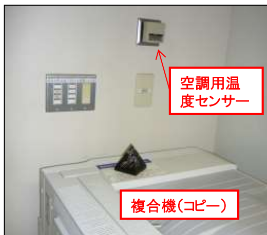
写真1 空調温度センサー付近の複合機
