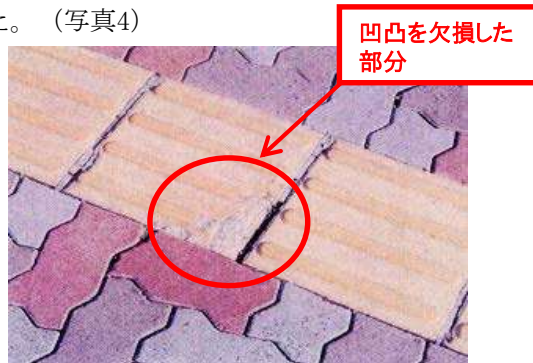
写真4 誘導ブロックを欠損
