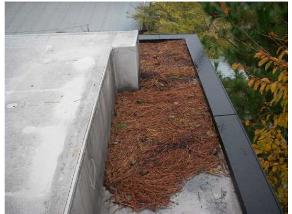
写真8 屋上部分などの落ち葉
