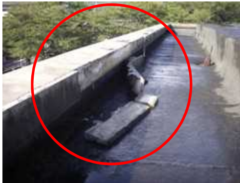
写真7 モルタル塗りの剥離
