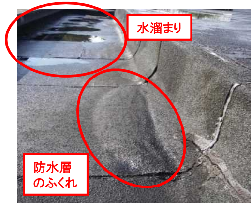
写真5 露出防水層のふくれなど
