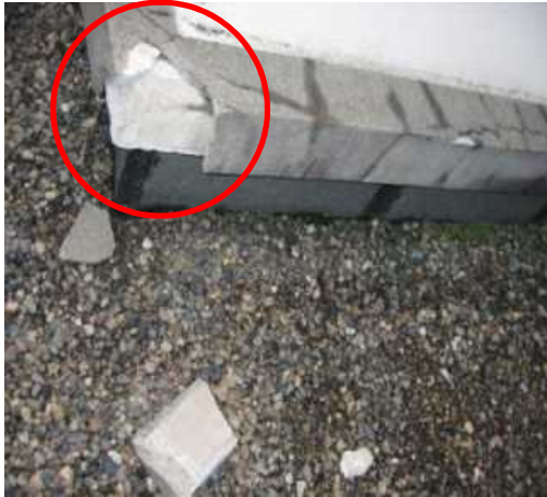
写真6 モルタル塗りの剥落
