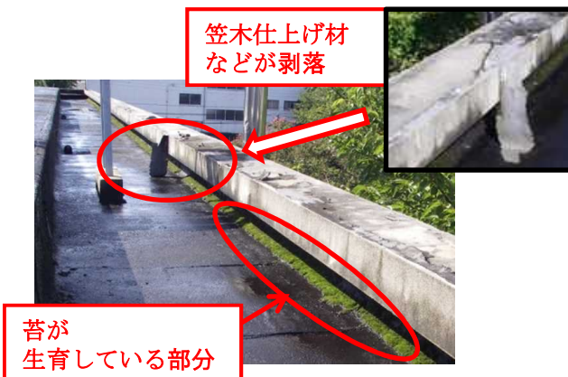
写真4 苔などが生育・笠木仕上げ材の剥落
