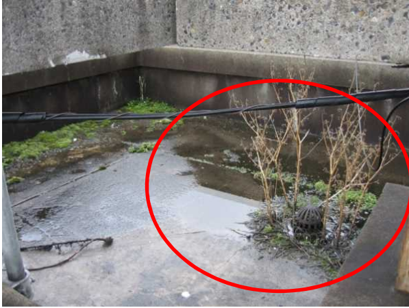
写真3 ルーフドレン廻りに雑草が生育し、ルーフドレンが目詰まり
