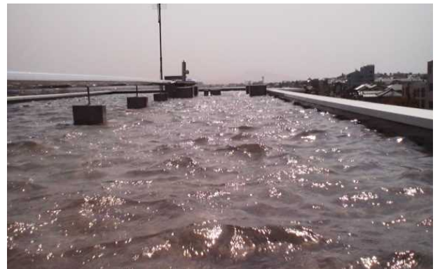
写真9 ルーフドレンの目詰まりによる屋上のプール化の状況
