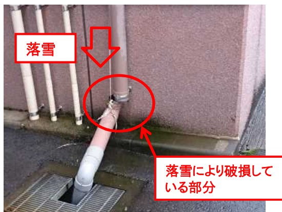
写真2 雨水用ドレン配管が破損
