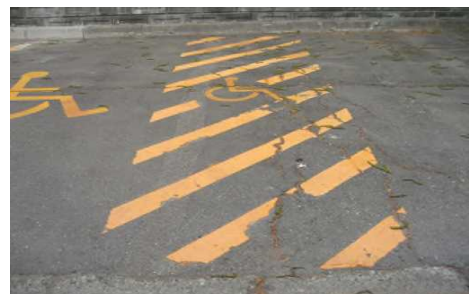
写真5 アスファルト舗装の区画線の欠損
