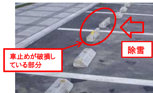
写真3 車止めが破損
