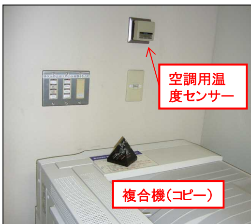
写真1 空調温度センサー付近の複合機
