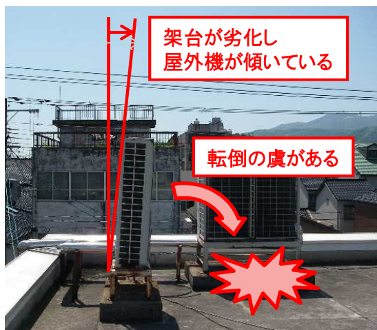
写真5 架台が劣化し傾いたエアコン屋外機
