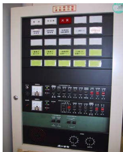
写真6 受信機（連動制御装置一体型）
