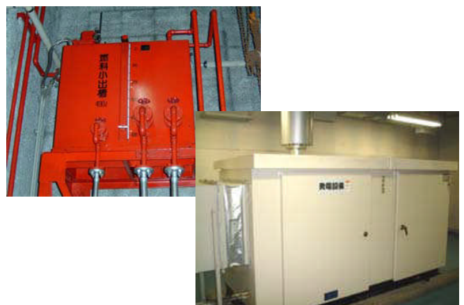
写真3 燃料タンクと発電装置
