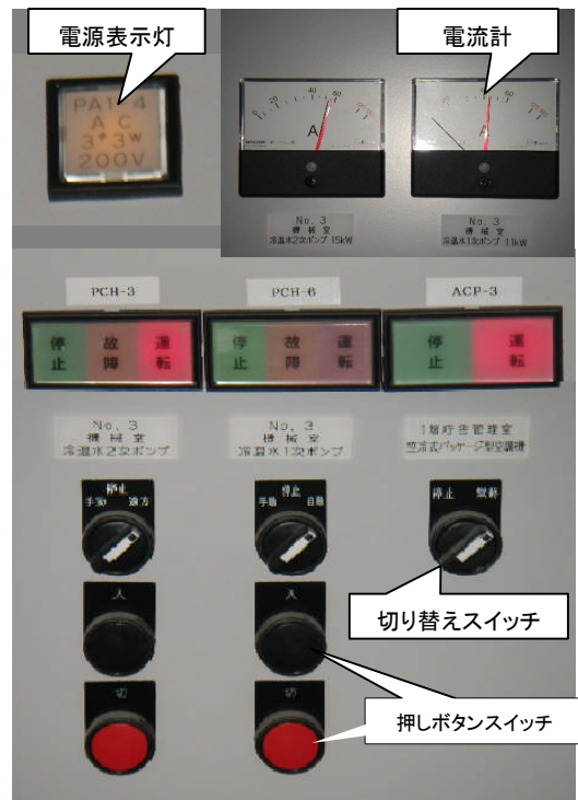
写真1 制御盤表面機器類
