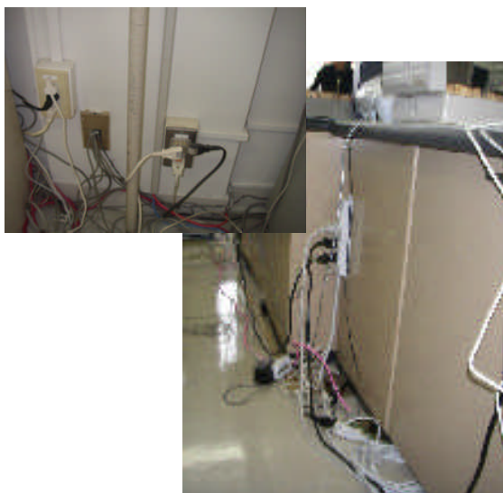
写真4 煩雑となってしまっている配線
