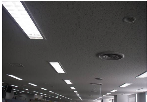
事務室天井の照明器具
