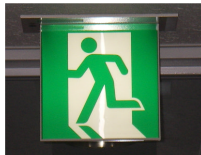
避難口誘導灯
