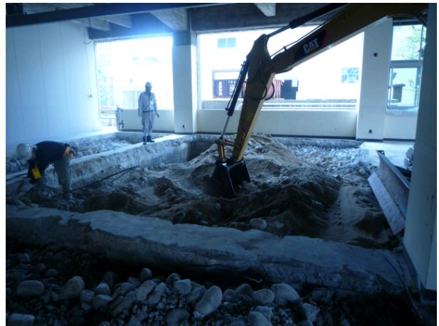
1階室内の床下を掘削(床下に免震ピットを造る):工程③
