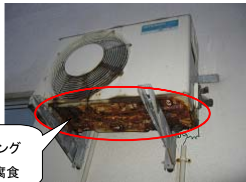
事例8：日常の安全な通行に支障
