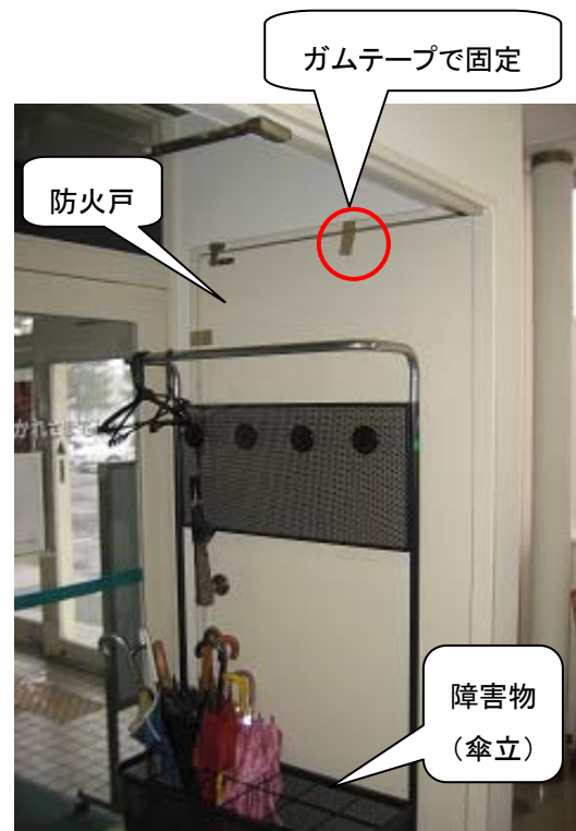
事例1：防火区画の形成に支障（2）
