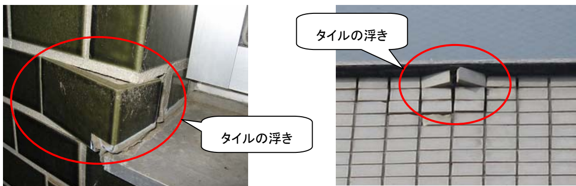
事例 8 : 日常の安全な通行に支障
