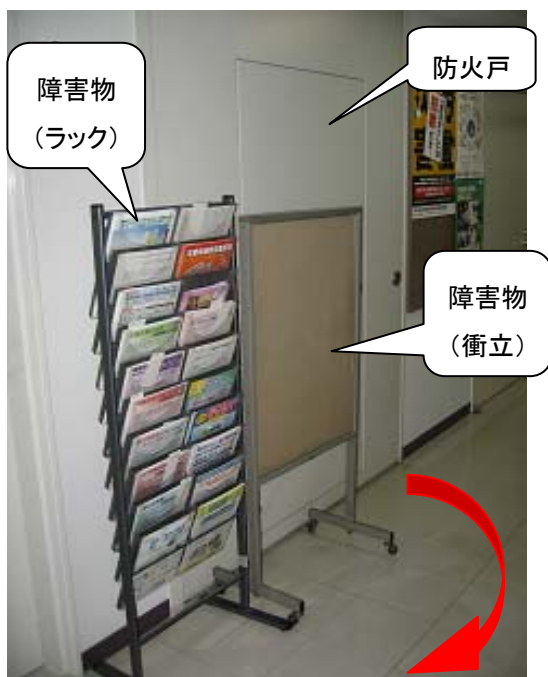
事例1：防火区画の形成に支障（1）
