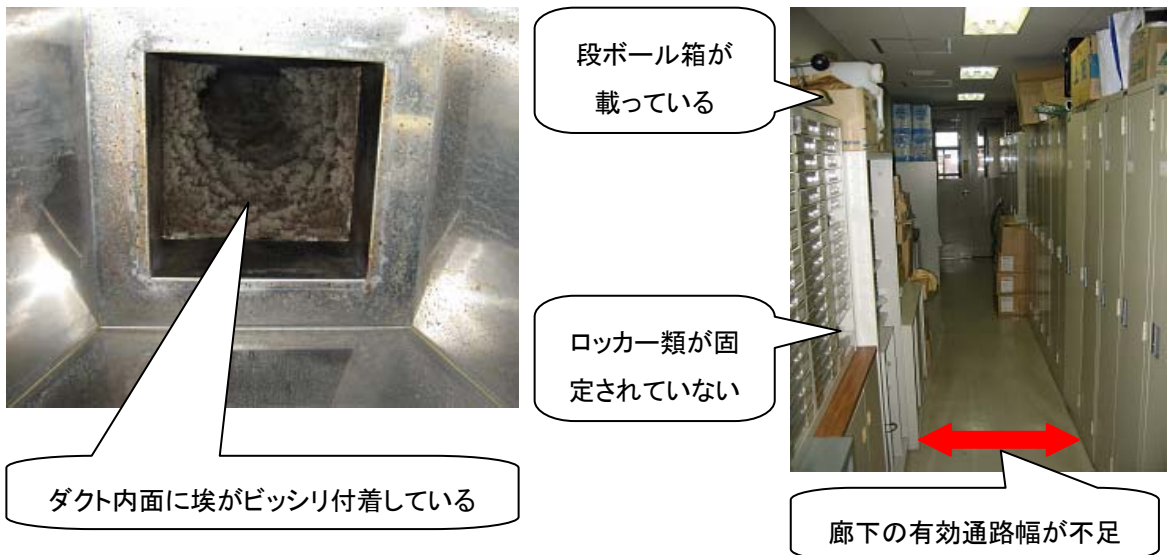
事例 6 : 湯沸室・厨房の防火管理に支障
