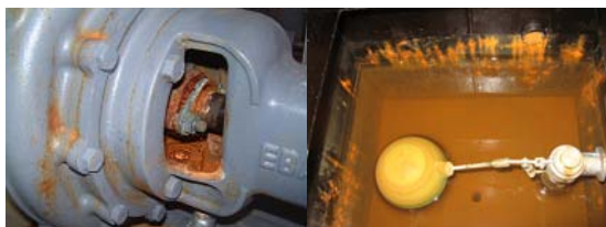
冷温水ポンプ: グランドパッキン部 から多量の漏水あり
