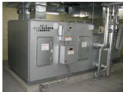
空調機:ユニット形空気調和機
