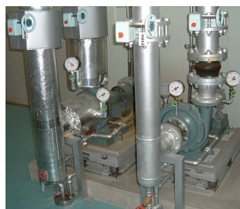
空調用ポンプ:冷温水(左) 冷却水(右)
