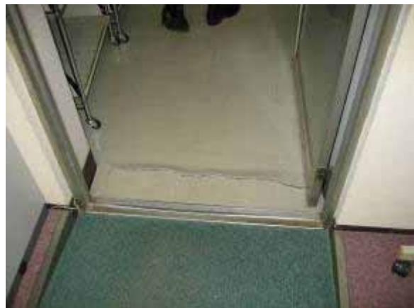
写真2 床のひび割れ（柏崎市）
