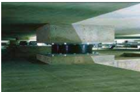
免震装置(新潟美咲合同庁舎1号館)
