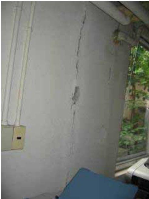
写真3 内壁のひび割れ（柏崎市）
