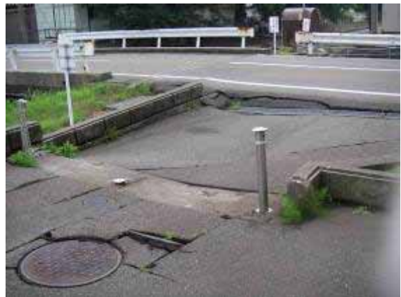
写真1 舗装のひび割れ・陥没（柏崎市）
