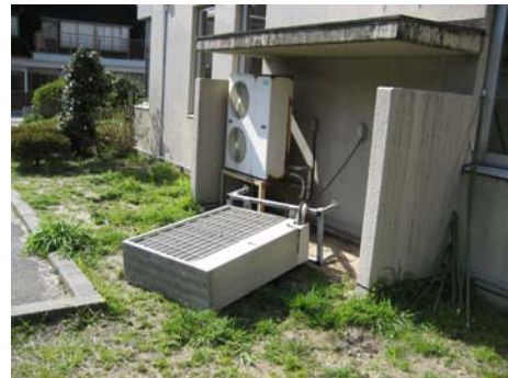
写真3 室外機の転倒（輪島市）
