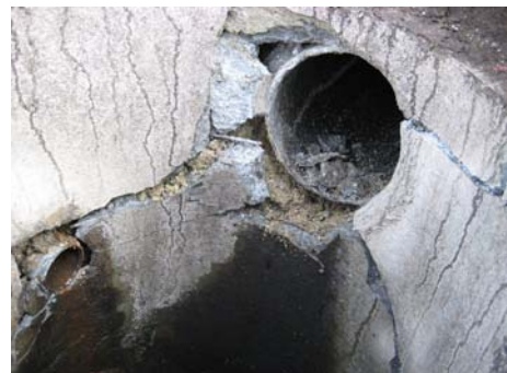
写真5 排水桝の破損（輪島市）
