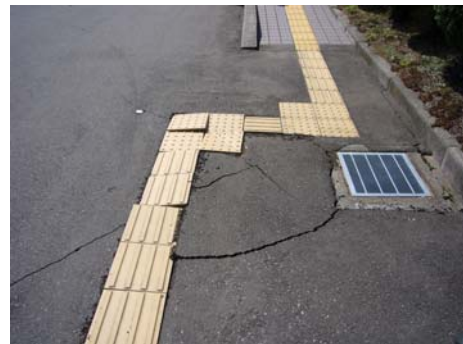
写真4 舗装のひび割れ（輪島市）
