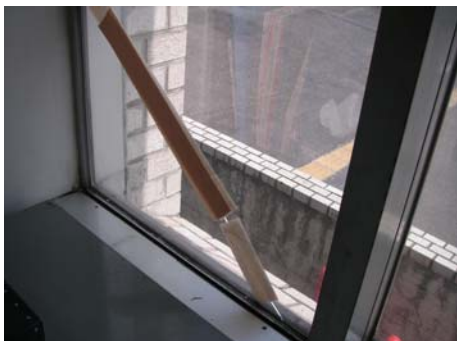
写真2 窓ガラスのひび割れ（富山市）
