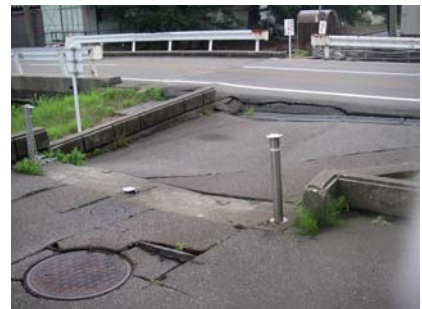
構内舗装の陥没(柏崎市)
