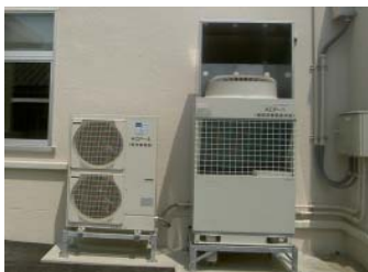
パッケージ形空調機(室外機)
