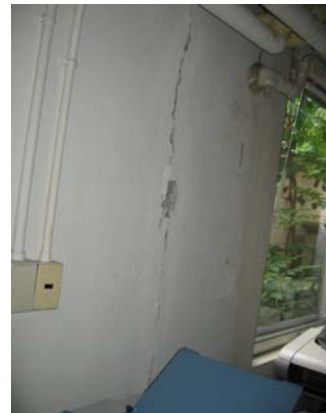
壁のひび割れ(柏崎市)
