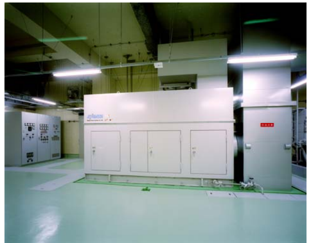
写真：自家発電設備(ガスタービン発電機) 新潟美咲合同庁舎内設置
