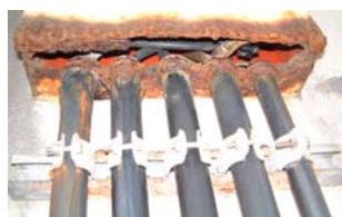
写真1：電気設備の腐食
