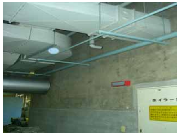
新潟法務総合庁舎 機械室 (吹付けアスベストの除去予定)
