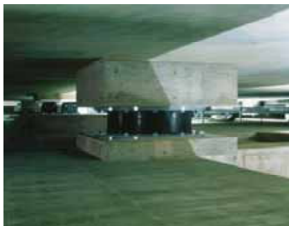
免震装置（積層ゴム支承）
