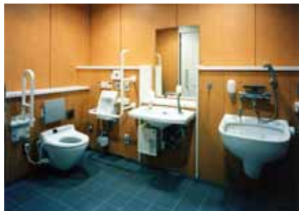
多機能トイレ（各階に設置）
