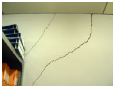
写真2 内壁のひび割れ
