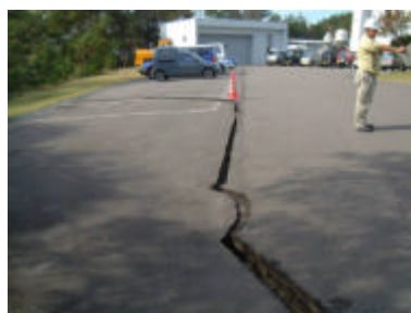
写真5 構内舗装のひび割れ
