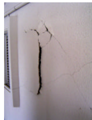
写真3 外壁のひび割れ
