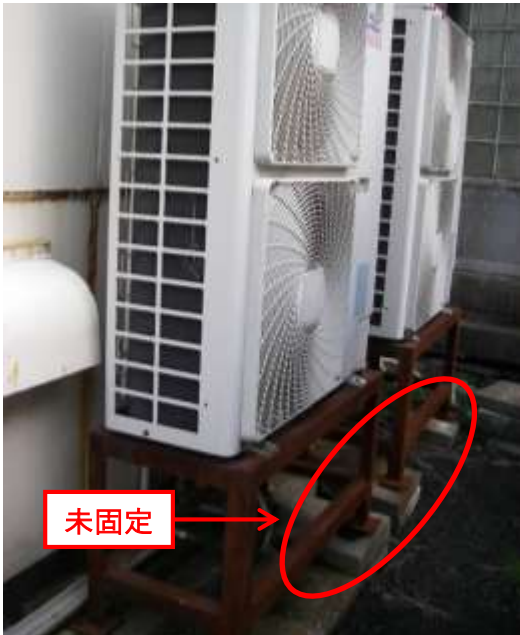
写真4 エアコン屋外機未固定
