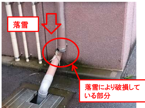
写真2 雨水用ドレン配管が破損
