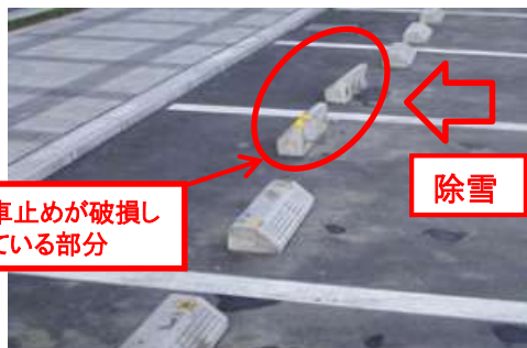
写真3 車止めが破損
