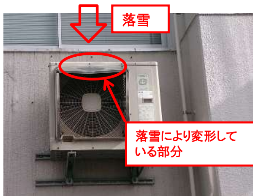
写真1 室外機用フードが変形
