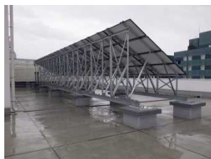
太陽光パネル
