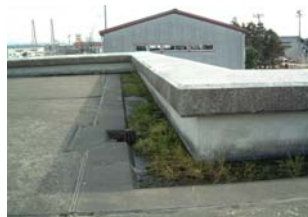
写真2：屋上の雑草 (屋上防水層の保全のため、 除草の必要があります。)
