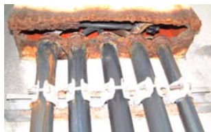
写真1：電気設備の腐食
