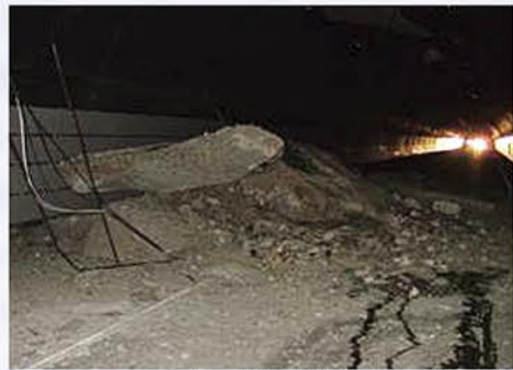
トンネル内に落下したコンクリート塊
