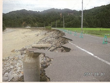
国道289号道路流出(五十嵐川沿い)
