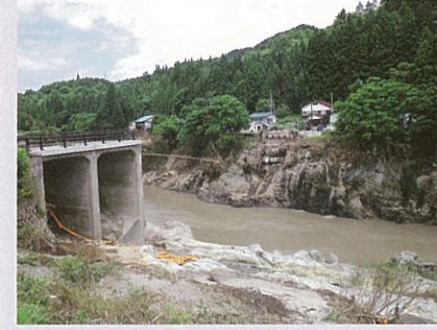
国道252号二本木橋落橋
