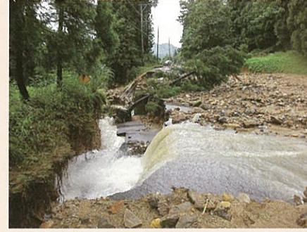
国道289号道路流出
