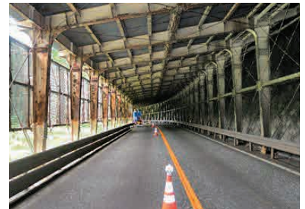
スノーシェッド柱部の腐食
