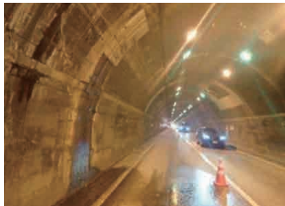
トンネル壁面からの漏水
