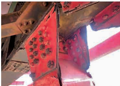
橋梁部材の腐食
