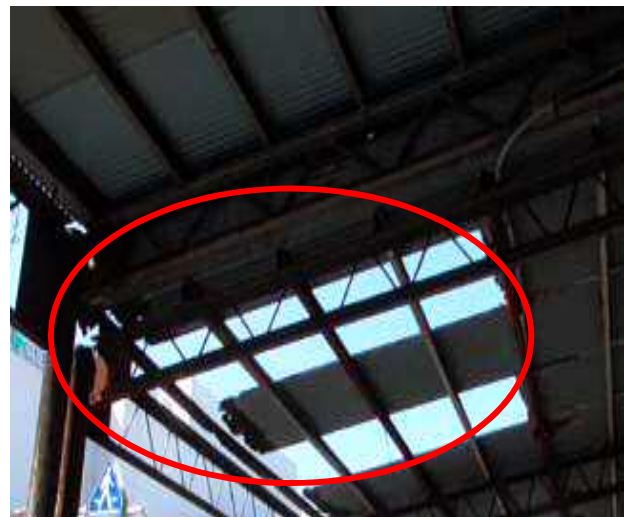
老朽化による崩壊の危険のあるアーケード
