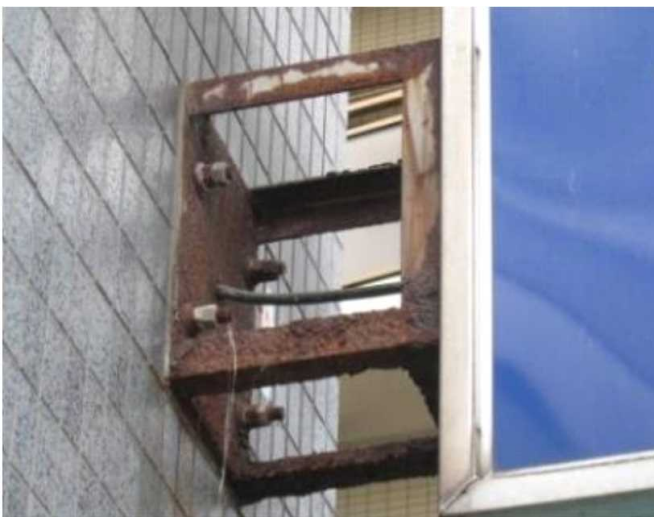
ブラケットの腐食による落下の危険のある看板 (国土交通省HPより)
