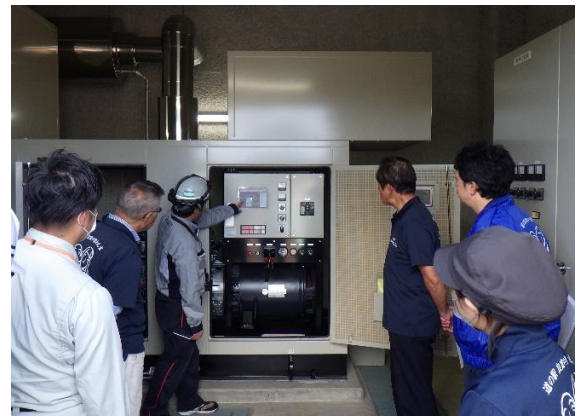
【非常電源用発電機の説明】
