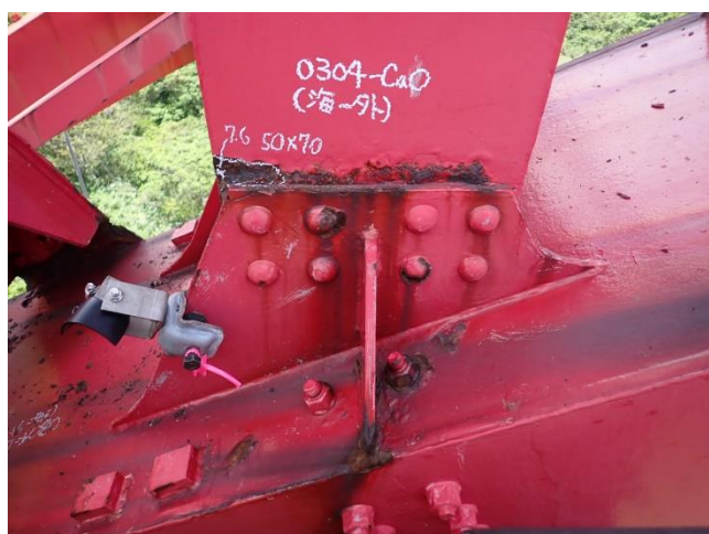
損傷状況③
