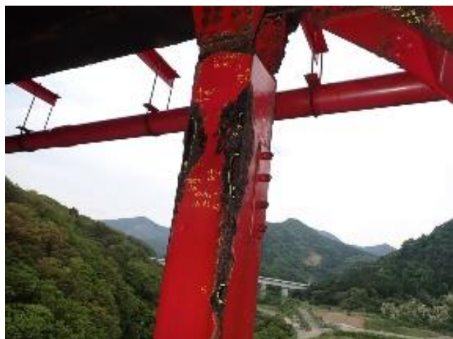
損傷状況②
