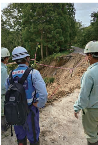
道路の被災状況調査
