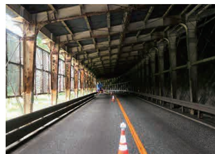
スノーシェッド柱部の腐食
