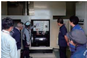
道の駅「良寛の里わしま」 非常用電源起動訓練
