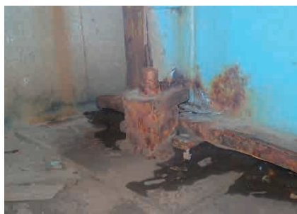
橋梁支承および桁端部の腐食
