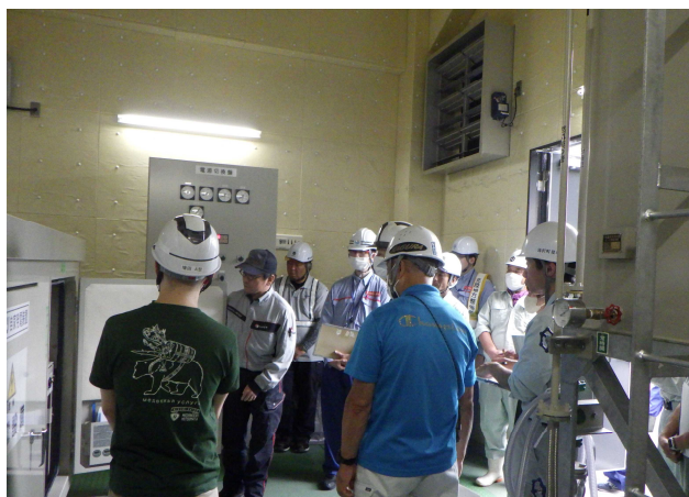
【非常電源用発電機の起動操作訓練】 非常電源用発電機の起動方法、 注意点の確認
